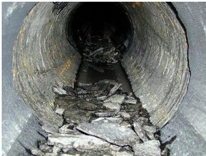
Рисунок 1. Засорение трубы на жд дороге.
